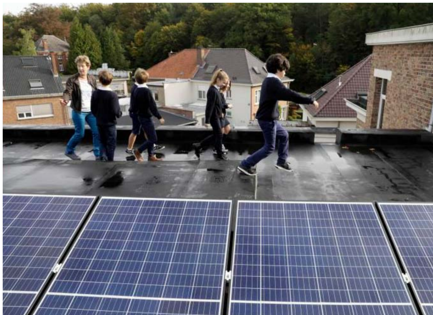
Aux Servites de Marie, à Uccle, Sun for Schools a installé 124 panneaux photovoltaïques qui produisent l'équivalent de la consommation de dix ménages par an. © SYLVAIN PIRAUX.
